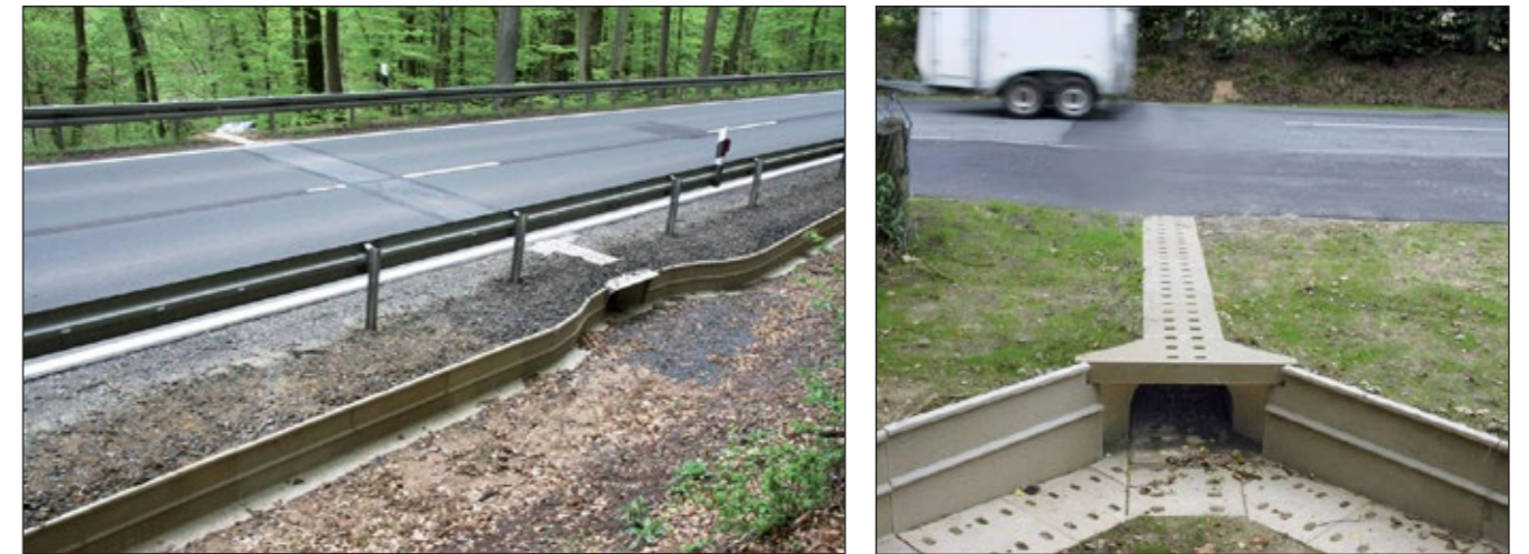
Figure 22: Crapauduc. Un mur de guidage évite que les amphibiens atteignent la route où ils risquent d'être écrasés. Les batraciens peuvent traverser la route par un petit tunnel avec quelques trous d'éclairage. Le mur de guidage doit être nettoyé régulièrement afin d'éviter que les amphibiens escaladent le mur (photos www.aco.fr).
